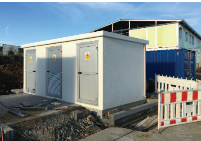
Installation d'un nouveau poste de transformation pour le Camp provisoire des demandeurs de protection internationale au Herrenberg
