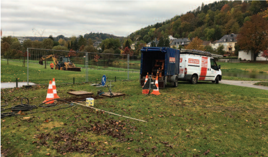
Pose d'un multitubulaire au camping municipal pour enfiler des fibres optiques pour la télésurveillance des installations électriques, ainsi que le transfert des données des compteurs intelligents
