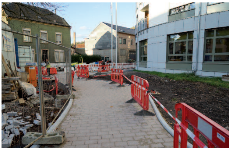
Nei ugeluechten Trottoire bei der Sauerbréck
