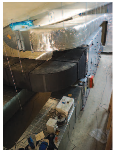
Local technique au sous-sol
