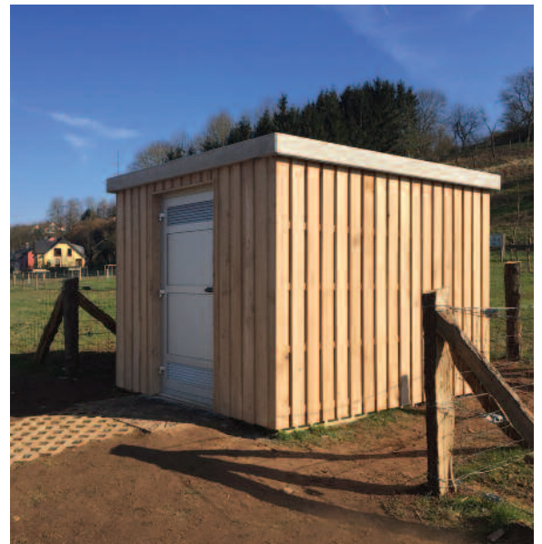
Site “Al Schwemm”: Construction d’une station de commande pour la piste canoë
