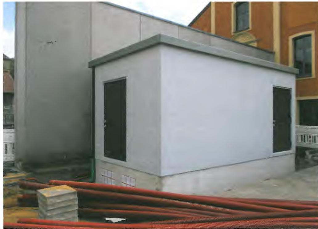
Nei Trafosstatioun um Site «Al Seeërei»
