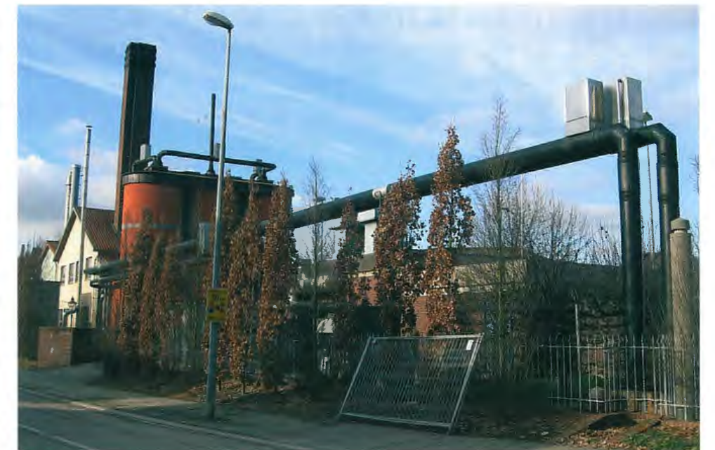
Cogénération à Diekirch, rue Sauerwiss
